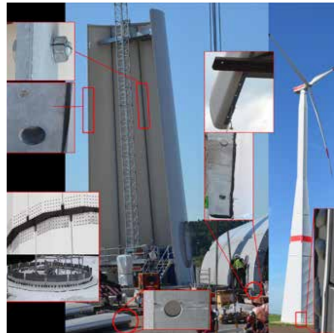
Aktuelle Anwendungsfälle gleitfester Verbindungen sowie auftretende Imperfektionen
